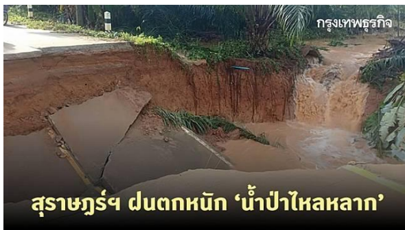
วันที่ 25 ต.ค. 63 น้ำป่าไหลหลากเข้าท่วมบ้านเรือนในหลายอำเภอ ที่เป็นพื้นที่เสี่ยงจังหวัดสุราษฎร์ธานี ระดับน้ำสูง 30-100 ซม.
