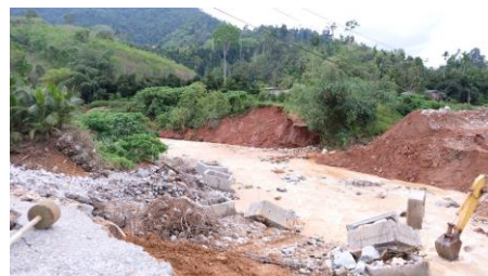
วันที่ 17 ก.พ. 65 น้ำหลากทำคอสะพานเสียหาย อ.บึงพิศำ จ.นครศรีธรรมราช
